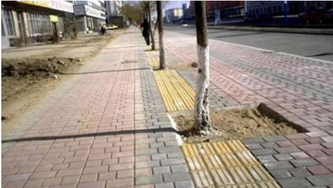
Εικόνα 13. Μη λειτουργική λωρίδα κίνησης τυφλών στο Πεκίνο, Κίνα. Ο σχεδιασμός του οδηγού διακόπτεται από φυτεύσεις
